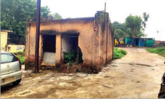
पंचायत भवन के सामने स्थित खंडहर भवन ।
